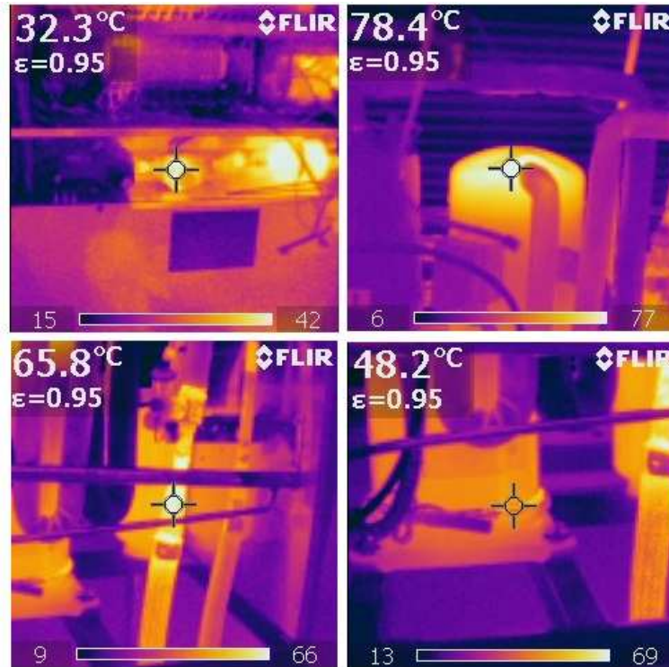
Figura 5: Imagens da radiação térmica dos componentes internos de um evaporador no sistema de climatização de uma sala segura, tais como: linha frigorígena (incluindo válvula de expansão, filtro secador) e compressor.
